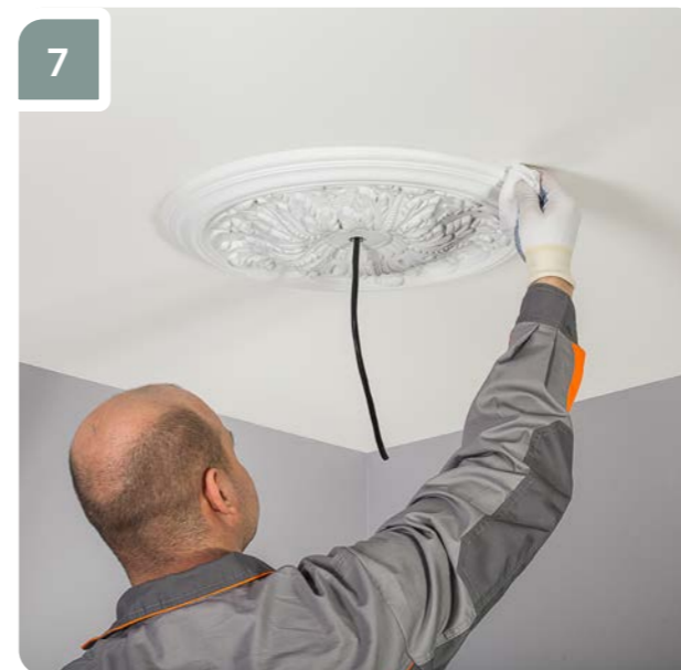
7 При необходимости места примыкания изделия к потолку протереть ветошью, смоченной водой — при использовании клея «Европласт Монтажный» или ацетоном — при использовании клея «Европласт Универсальный».
